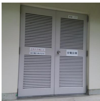
電力会社借室
